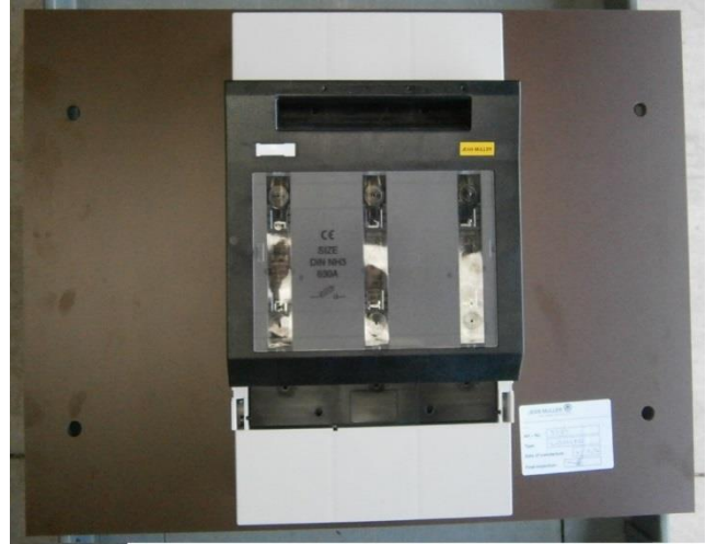
300KVA tx 1 x LTL3-3 630 amp
